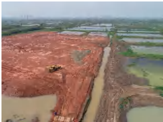
K22+300 梁子湖服务区临时排水沟
