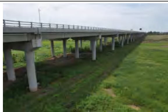
K31+100 施工便道以及桥下扰动迹地恢复现状
